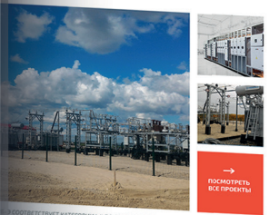
Изоляция электрооборудования КТП-Э соответствует категории «А» по ГОСТ 9920-89
