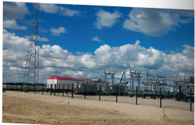
Изоляция электрооборудования КТП-Э соответствует категории «А» по ГОСТ 9920-89
