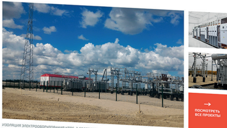
Изоляция электрооборудования КТП-Э соответствует категории «А» по ГОСТ 9920-89
